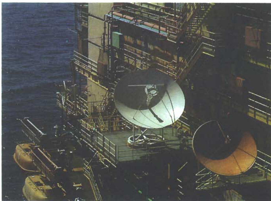
O sistema de comunicações via satélite une as plataformas da Bacia de Campos.
