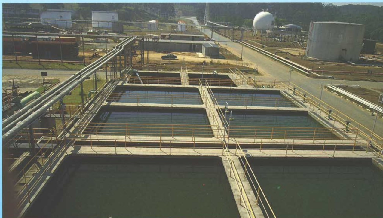
Estação de tratamento de água na Refinaria de Capuava, em São Paulo
